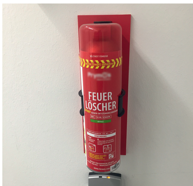
Feuerlöscherspray Office auf dem Eye-Catcher mit rotem Hintergrund montiert
