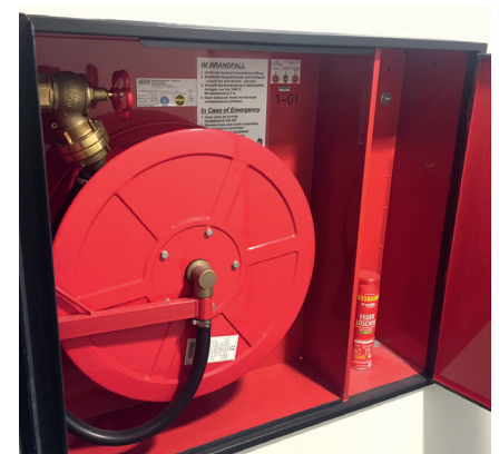
Feuerlöscherspray auch im Wandhydranten zu finden
